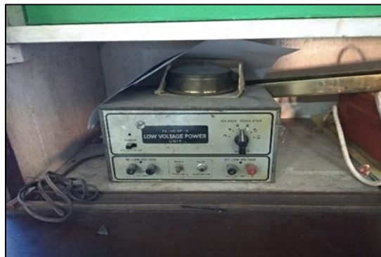
Gambar 3.80 Power Supply yang sudah rusak
