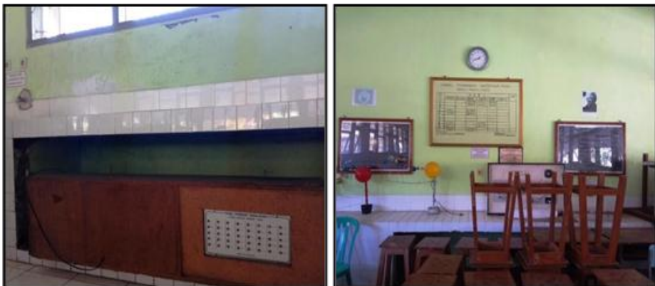
Gambar 3.140 Dinding yang keropos dan pudar, wastafel yang kotor, serta meja dan kursi yang rusak.
