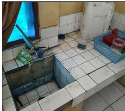
Gambar 3.19 Kondisi air tidak mengalir dan wastafle kotor
