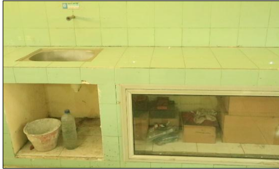
Gambar 3.72 Wastafel yang tidak dapat digunakan
